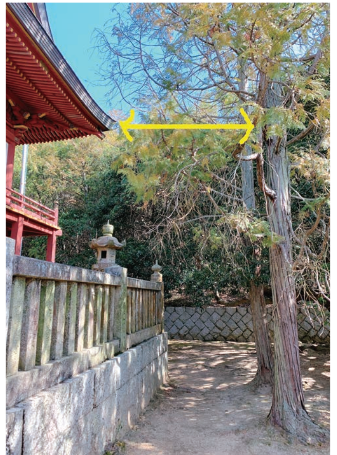
本殿側面。立木が高く、本殿に近い。対処の必要がある。(鴻八幡宮)
