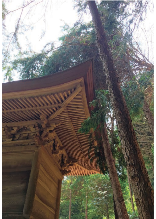
本殿裏の立木が接触 (武苔神社)
